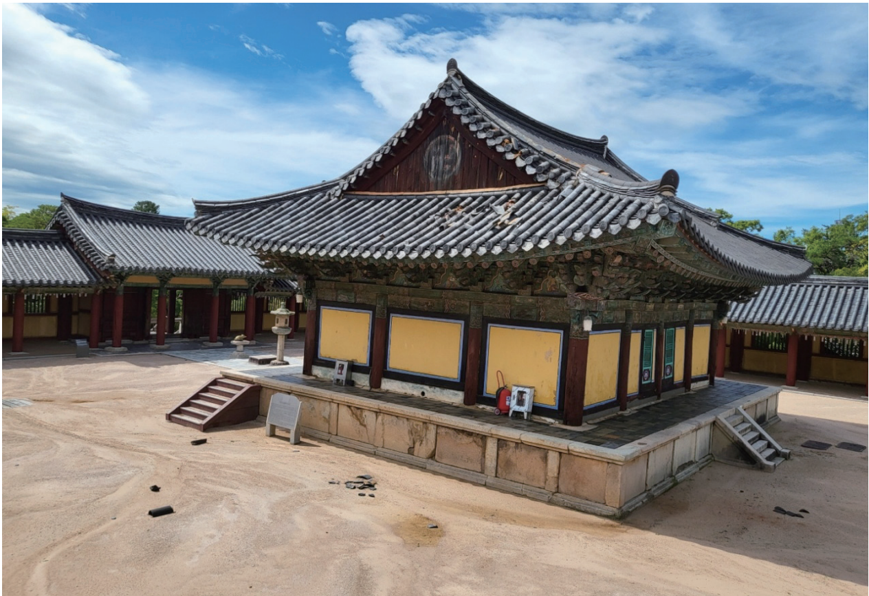
佛国寺正殿更乐殿屋顶瓦片脱落
